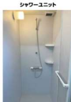
シャワーユニット
